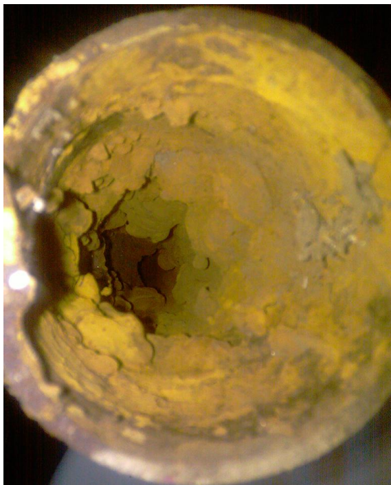
Рис. 2. Фрагмент стояка отопления с внутренними отложениями
