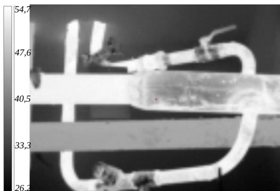
Рис. 1. Тепловизионная картина труб систем отопления
