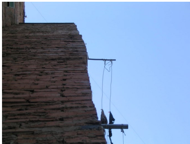
Рис. 2. Геометрические отклонения кирпичной кладки от вертикали
