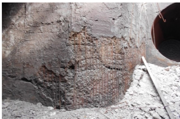
Рис. 2. Характер разрушения поверхности сооружения боровов дымовых труб
